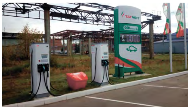
Рисунок 7. Оформление зарядной станции на территории технопарка «Химград» в Казани
